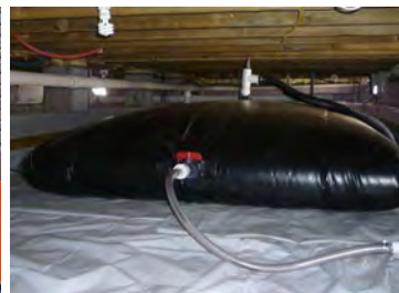
regenwaterzak in kruipkelder
